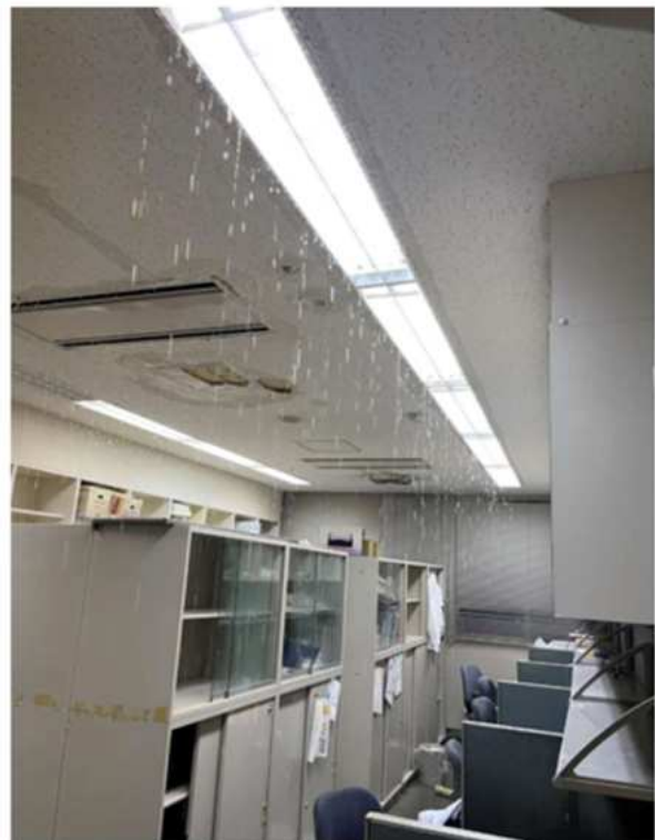
スプリンクラーの配管が損傷
