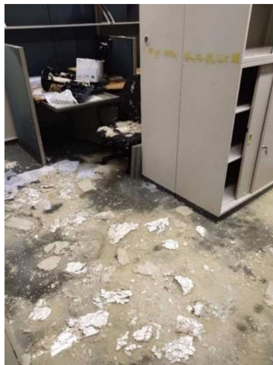
スプリンクラーの漏水で天井板が崩れた
