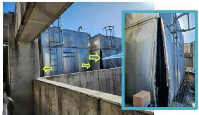
屋上の高架水槽2基も高さ2mのパネルが裂けて漏水
