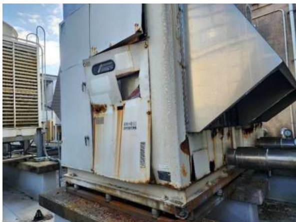
破損した冷却機
