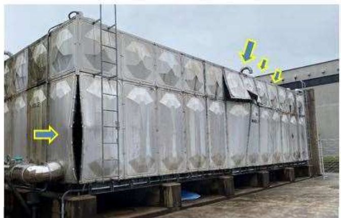
1F 貯水槽はパネルの複数破断で全ての水を失った
